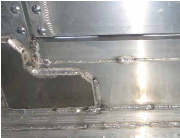
Gutes Beispiel: Scharfe Kanten wurden abgerundet.
