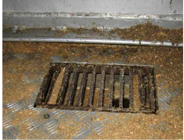
Abflussloch mit zu breiten Spalten
