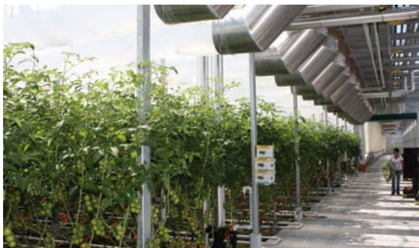
Wenn die Arbeiterinnen ernten oder die Stauden pflegen, können die luftführenden Rohre an die Decke gehoben werden.
