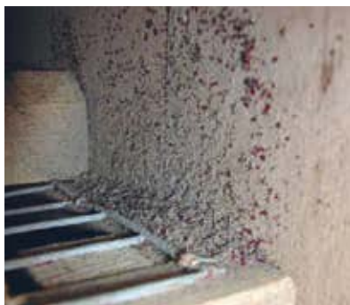
Solche «Salz-und-Pfefferstellen» und sogar tagsüber sichtbare Milben weisen auf einen sehr starken Befall mit Vogelmilben hin.
