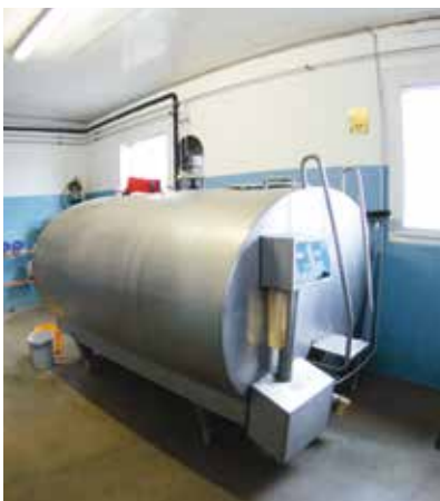
Wärmepumpen sind bei grossen Kühltanks sinnvoll.
