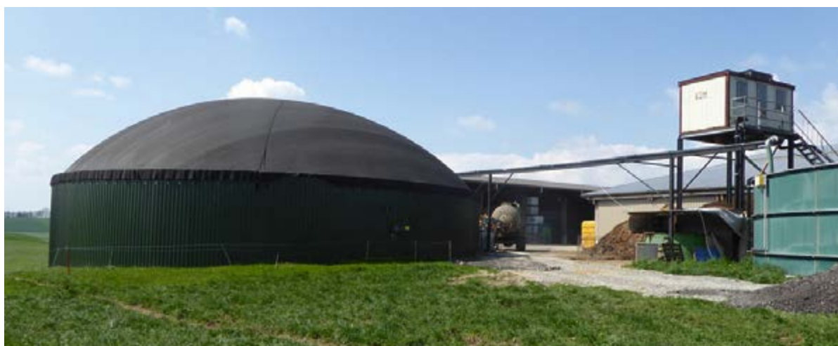
Die Anlage auf dem Betrieb Zosso produziert jährlich rund 700 000 kWh Strom. Bild: Andreas Messerli
