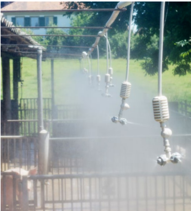
Vernebelungsdüsen, wie man sie aus dem Gewächshaus kennt, erzeugen einen angenehm kühlen Nebel über dem Auslauf. Bild: Mirjam Holinger
